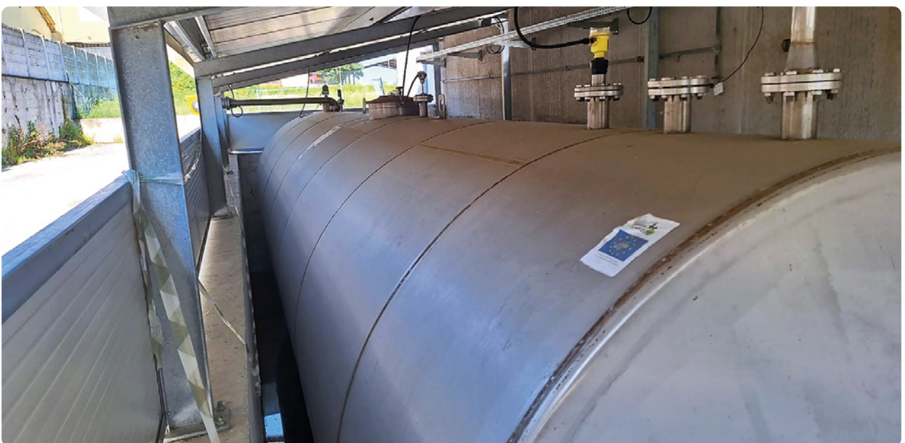
Cisterna di stoccaggio del monomero di recupero (r-MMA) Storage tank for the recovered monomer (r-MMA)
